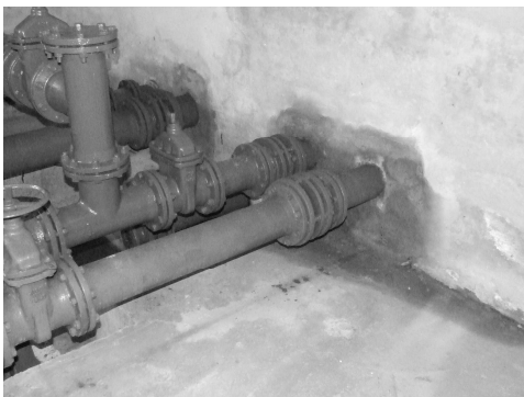
Obr 1. Projev nežádoucího stavu 05 – navlhání betonové konstrukce
